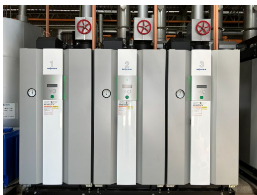
▲更新した加古川製造所の蒸気ボイラー
