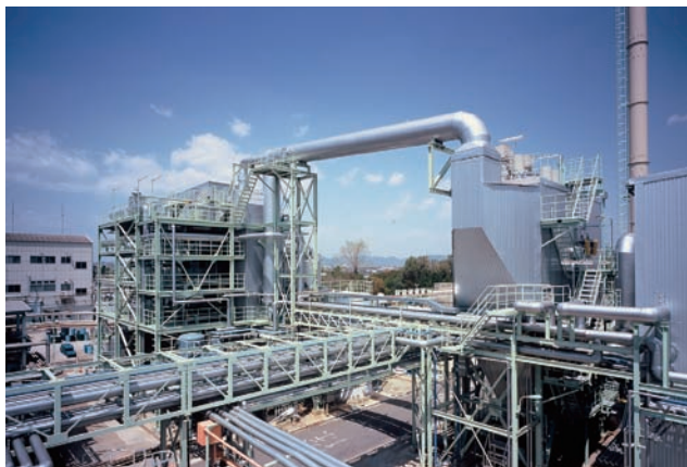
▲バイオマス発電設備
