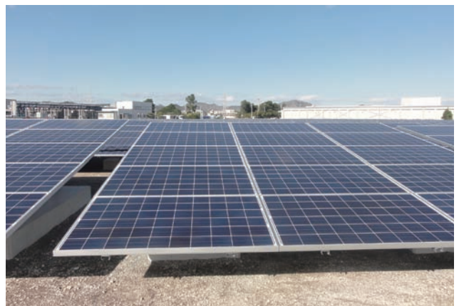
▲伊保港に保有する敷地に設置した太陽光パネル
