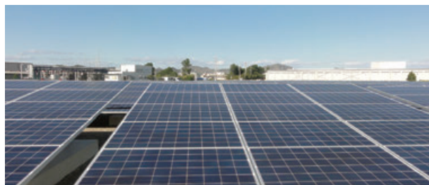
▲伊保基地に設置した太陽光パネル
