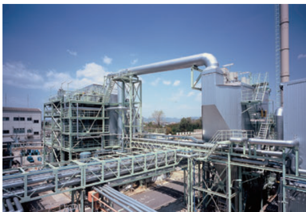
▲バイオマス発電設備
