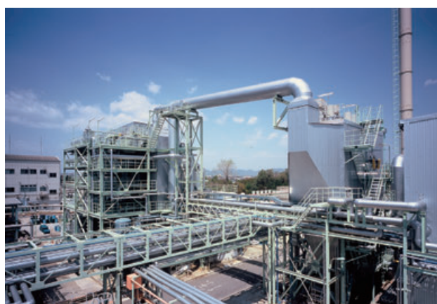
▲バイオマス発電設備
