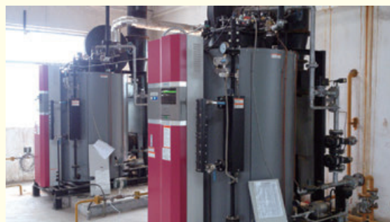
▲稼働を開始した天然ガス蒸気ボイラー
