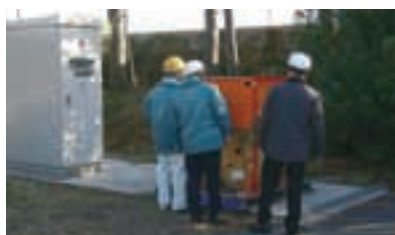
自家発電設備を設置し、災害発生時、社内及び近隣住民への電気供給に備えます。
